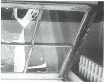
R-68 : altération du jet d'eau du vantail par l'humidité (1)
