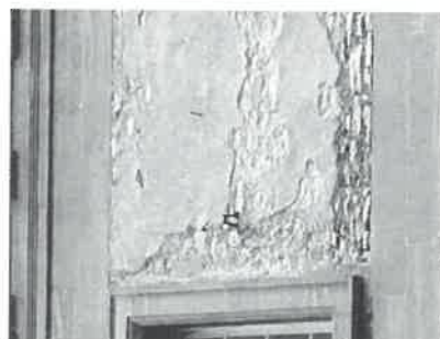
3-34/35 : disparition de l'enduit de dissimulation des reprises de maçonneries (6)
