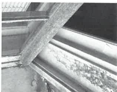
3-01 : traces d'infiltrations et de noircisseurs sur la tablette inférieure (1) (1)
