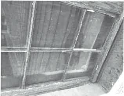
2-07 : désagrégation des mastics, écaillage des peintures, creusement des veines de bois (1) (2) (3)
