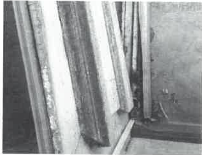
2-05 : défailance de l'étanchéité entre la pièce d'appui dormante et le revêtement en zhc de la terrasse (2)
