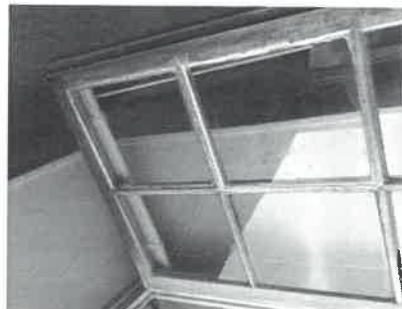
3-60 : accumulation de poussières et noircisseurs dus aux pollutions atmosphériques (5)
